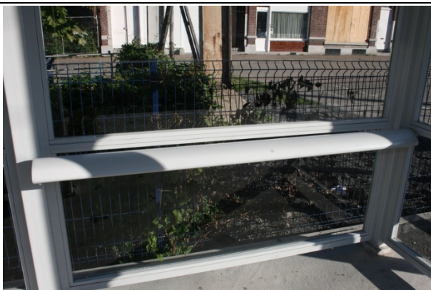
Barres d'appui dans les abris
