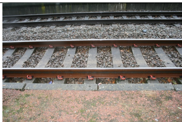
Absence de dalles podotactiles
