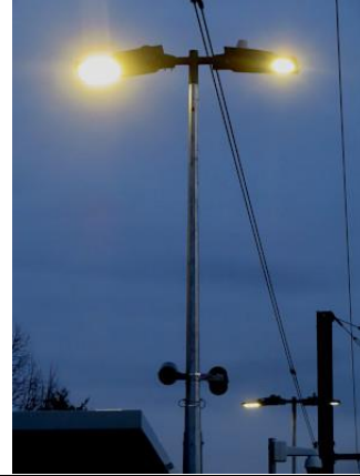
Le nouvel éclairage LED est opérationnel
