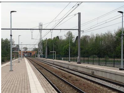
Eclairage LED des quais, avec haut-parleurs sur chaque mât
