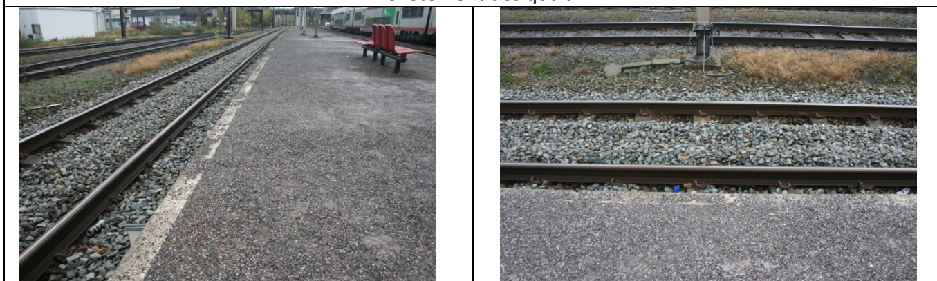
Absence de dalles podotactiles
